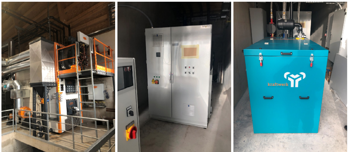
Abb. 31: Wärmeerzeuger Heizzentrale Wart
