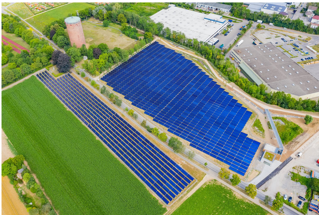
Abb. 61: Solarthermieranlage auf Ludwigsburger und Kornwestheimer Gemarkung (Quelle: SWLB)
