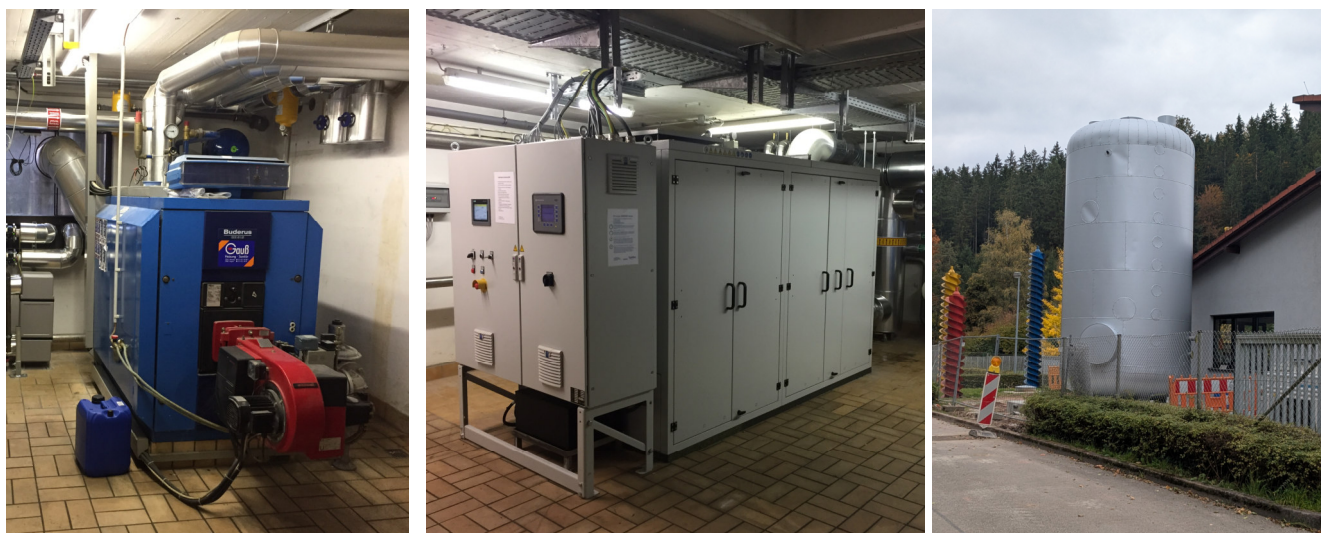
Abb. 34: Wärmeerzeuger Kläranlage Berneck
