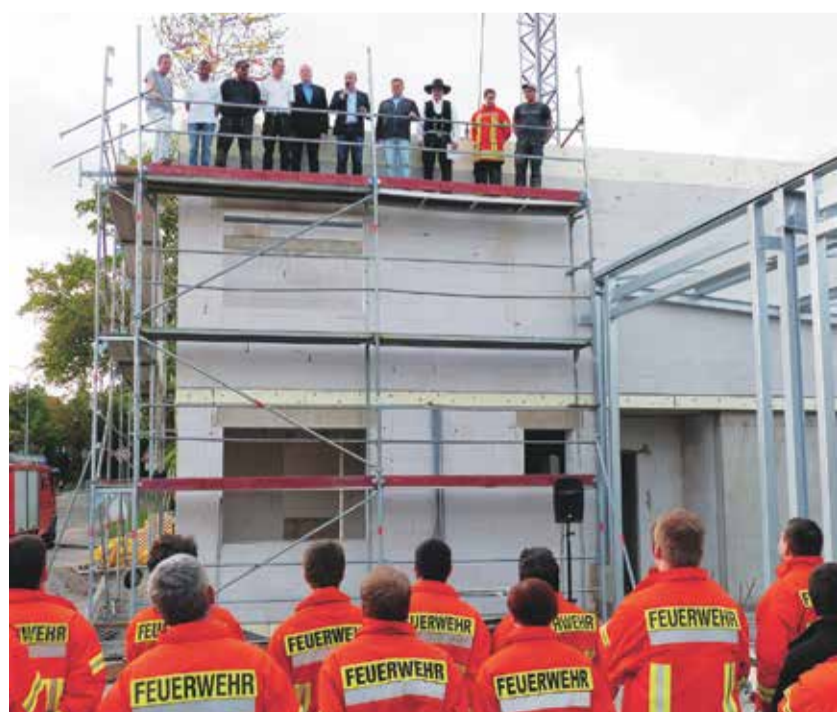
Spatenstich im März, Richtfest im Mai, Einweihung im Herbst – das Feuerwehrgerätehaus in Wart entsteht in Rekordzeit.
