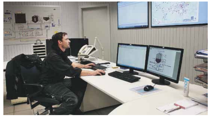
Betriebsleiter Tobias Weiß in der Leitwarte der Altensteiger Sammelkläranlage.
